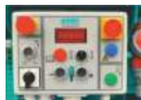
Panou de control cu inverter și afișaj interactiv
